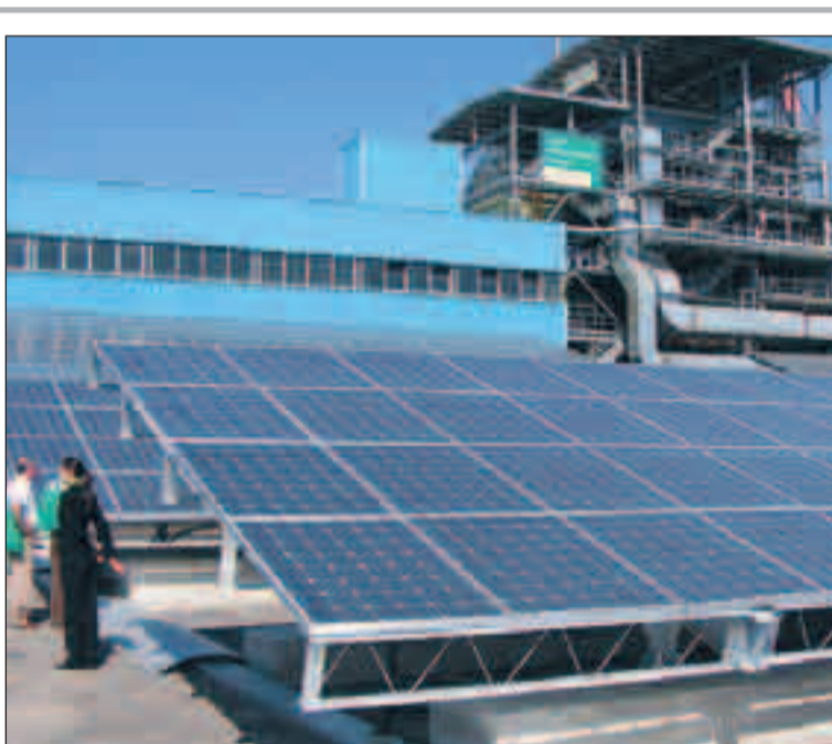
Il nuovo impianto fotovoltaico e a biomasse di Rende inaugurato ieri
